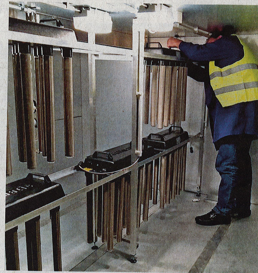
Am Frankfurter Flughafen setzt der Betreiber bereits auf Luftionisationsanlagen aus Bad Nenndorf. Die Anordnungen der länglichen Stäbe sind die Ionisations-Module.
